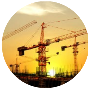
GRÚAS E INDUSTRIAS CRANES
